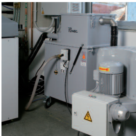
NA 250 Stålplåt utan restdamfilter med sugaggregat i plastbearbetning
