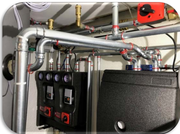
Rördragning och shuntpaket
