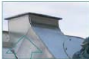
Utblås av reade luft
