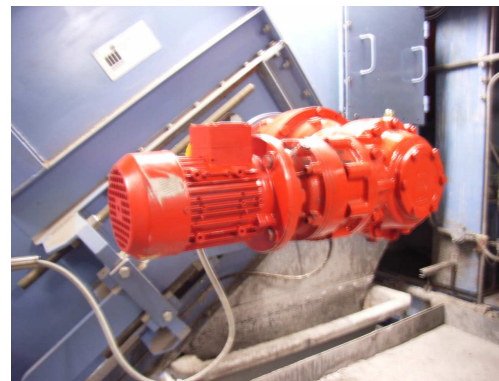
Byte utväxling, motor och monteringspos Tekniska Verken Linköping
