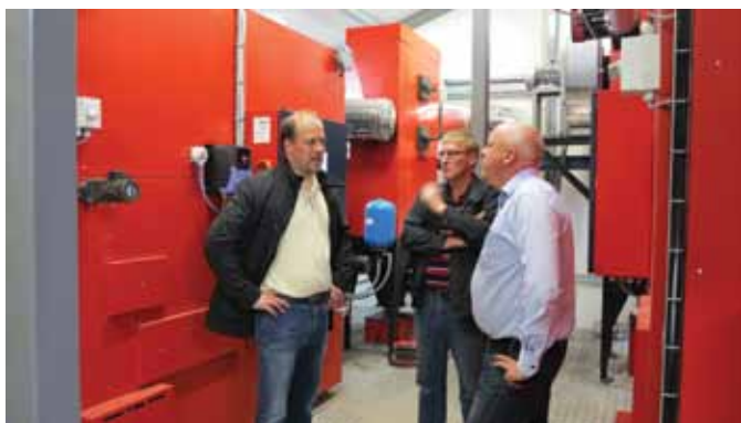
Inifrån anläggningen ser vi pannan NH200.
